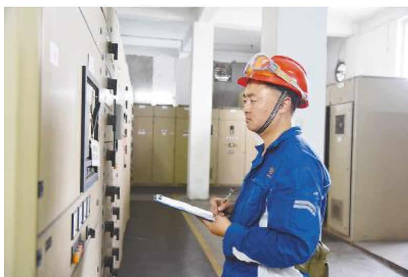
刘勋在配电室进行巡查
