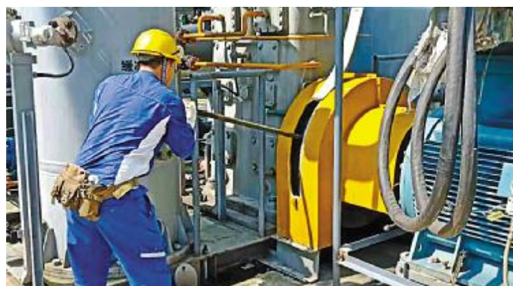
对设备进行检查
