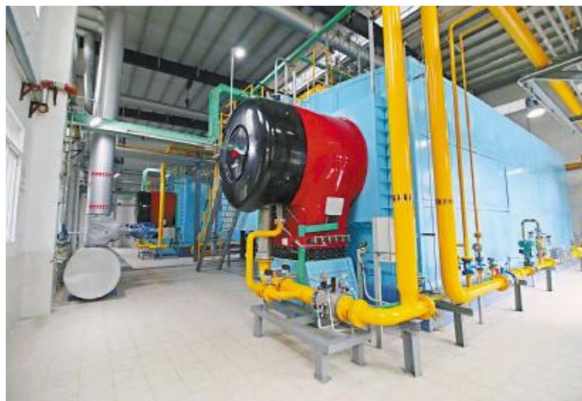
运行中的燃气锅炉
