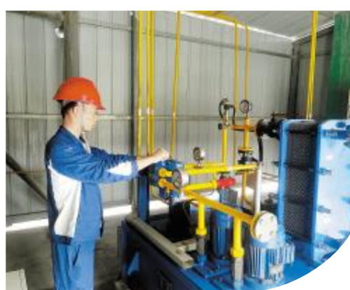
杨涛正在调整生料磨油站供油压力
