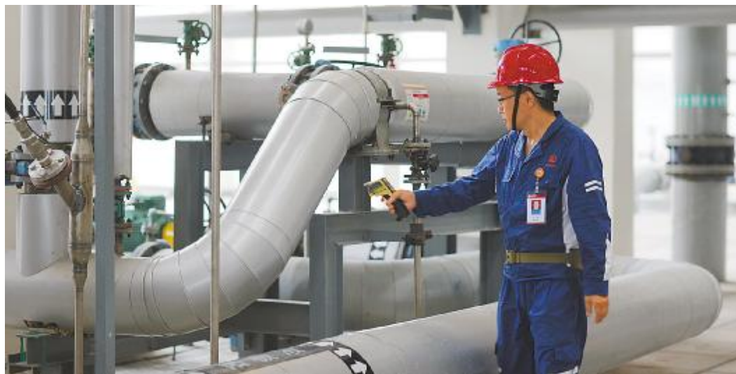
巡检设备杜绝跑冒滴漏
